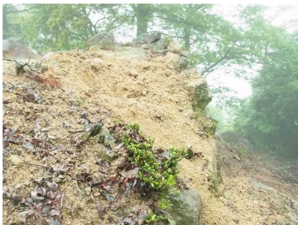
写真-8 平成 21 年の台風により崩れた石垣
