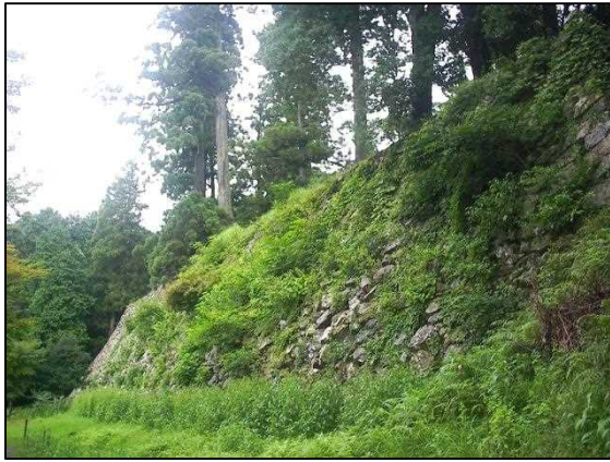
(写真-5) 石垣の草本・木本の繁茂
